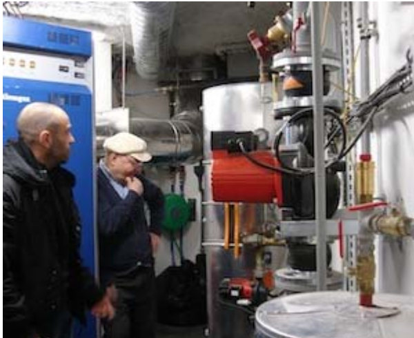
Dans la chaufferie des Trois Baudets
